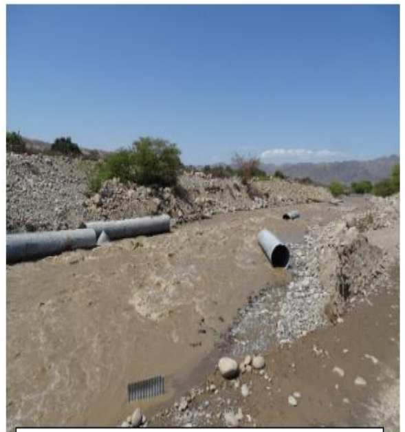
ALCANTARILLAS TMC ARRASADO POR LAS AGUAS DE AVENIDA UBICADOS EN EL DESVIO PROVISIONAL
