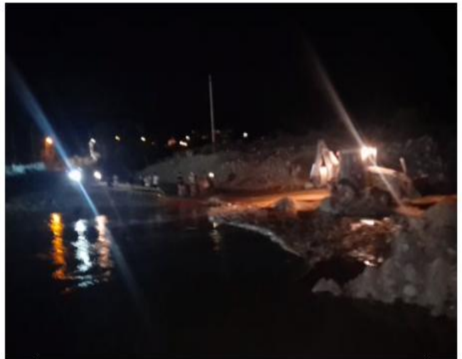
INTERVENCION DE MAQUINARIA DE LA EMPRESA CONSTRUCTORA EN EL REBALSE DEL AGUA
