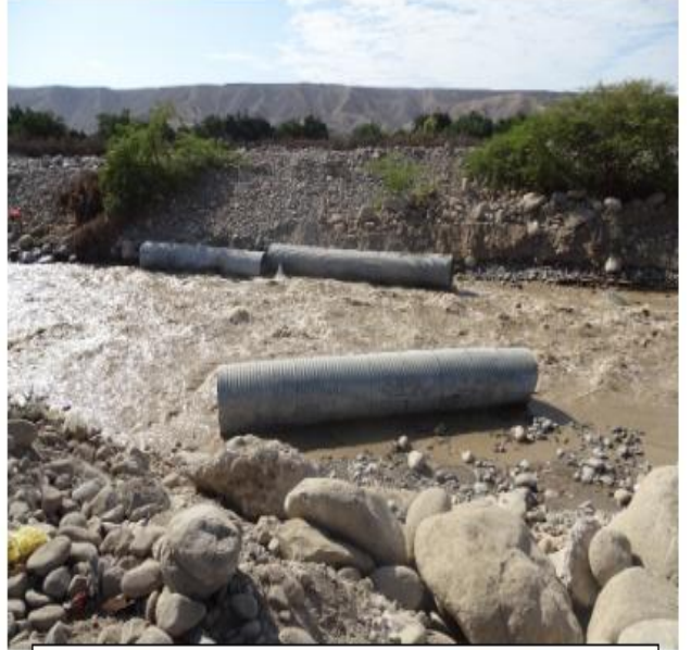
ALCANTARILLAS TMC ARRASADO POR LAS AGUAS DE AVENIDA UBICADOS EN EL DESVIO PROVISIONAL
